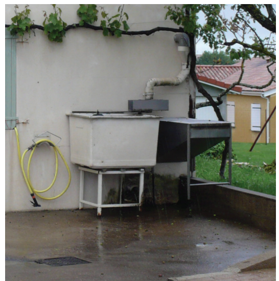
Vue des éléments : gouttière, cuve-tampon, filtre
