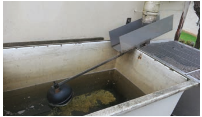
La cuve-tampon et la jauge en sortie de gouttière
