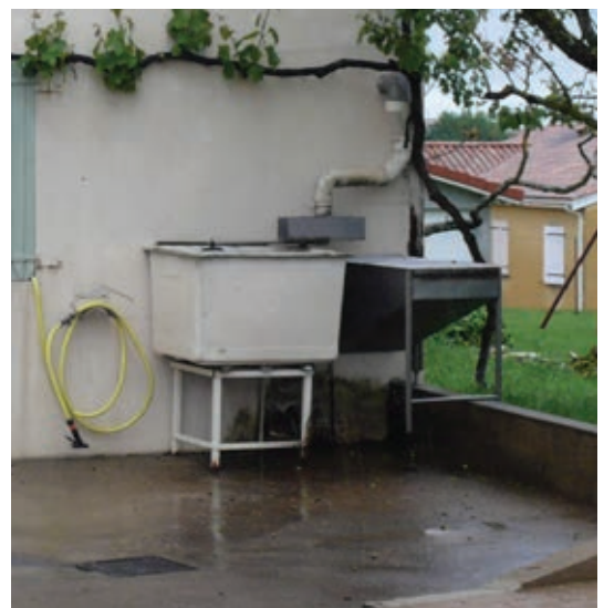
Vue des éléments : gouttière, cuve-tampon, filtre
