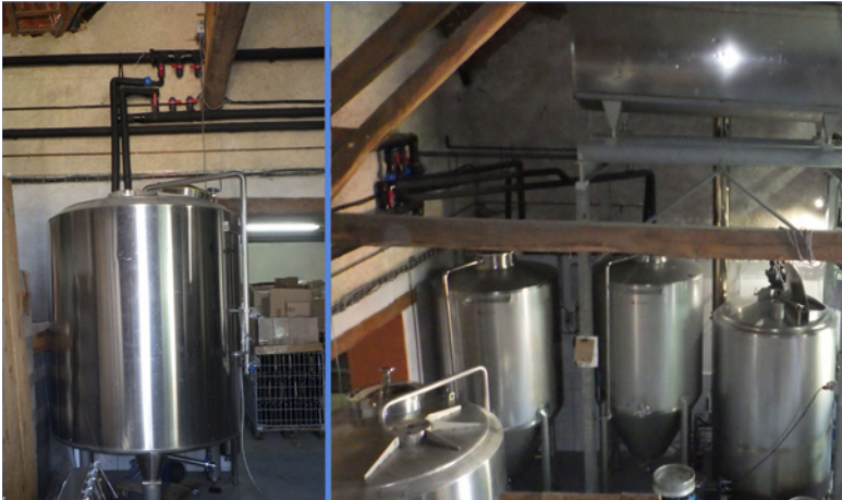
△ Photos du circuit.
